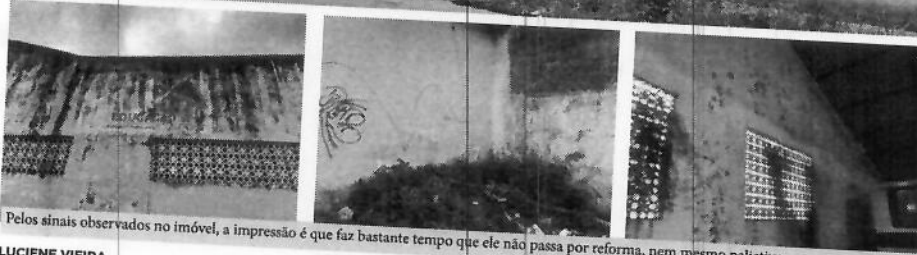
Garagem da Seduc, na Vila Passos, apresenta visíveis sinais de degradação
